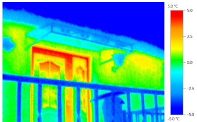
Bardzo niska jakość termiczna ram drzwi zewnętrznych. Widoczny efekt termiczny połączenia ścian z dachem.
