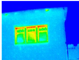
Ściany ocieplone, widoczne koronki łączników. Lokalne nieciągłości w połączeniu z dachem. Rama okienna o dość niskiej jakości termicznej.
