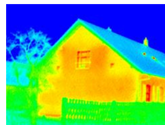
Dach izolowany, ściany bez izolacji. Widoczna część ogrzewana i nieogrzewana na poddaszu.
