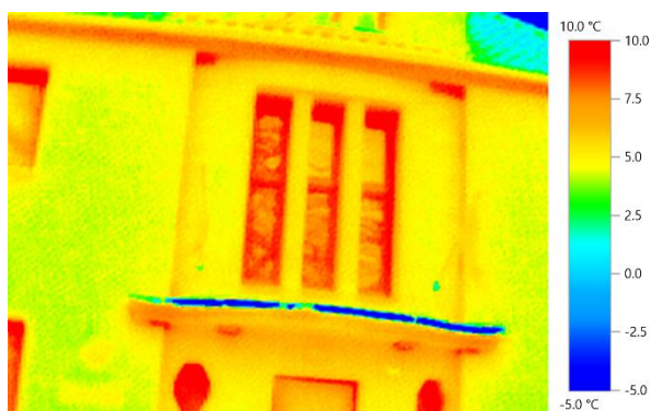
Rysunek 3.46. Budynek bez izolacji termicznej. Widoczna partia wejścia głównego ujęta dwoma owalnymi w kształcie otworami okiennymi, szklonymi prawdopodobnie pojedynczą szybą lub zasłoniętymi płytą o niskiej wartości oporu cieplnego. Wyraźne punktowe mostki termiczne połączeń ściany zewnętrznej z gzymsem oraz zadaszeniem wejścia głównego.
