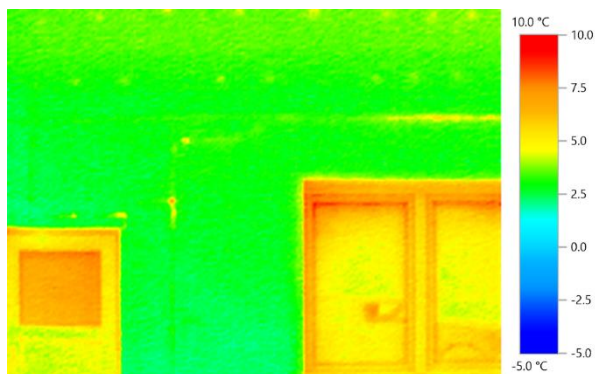
Rysunek 3.26. Obiekt izolowany termicznie. Widoczna liniowa nieciągłość izolacji termicznej ponad otworem okiennym oraz po jego lewej stronie. Liczne punktowe przebicia termoizolacji.
