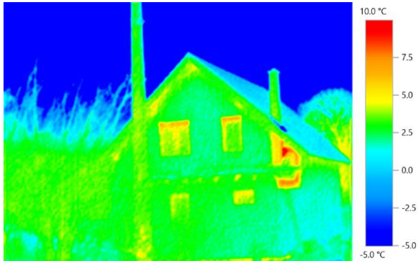
Rysunek 3.28. Budynek współczesny, izolowany termicznie. Widoczna nieciągłość izolacji termicznej na styku ściana – przewód spalinowy. Punktowe mostki termiczne ponad oknami parteru. Liniowe mostki termiczne połączenia ściany zewnętrznej z okapem.
