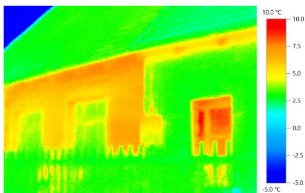
Rysunek 3.35. Budynek w zabudowie bliźniaczej. Prawa strona budynku poddana została termomodernizacji. Widoczny liniowy mostek termiczny spowodowany nieciągłością izolacji termicznej pomiędzy ścianą zewnętrzną oraz połacią dachu (segment prawy). Drzwi wejściowe (segment prawy) szklone prawdopodobnie szybą pojedynczą (widoczna wysoka temperatura na powierzchni zewnętrznej oszklenia). Segment lewy bez izolacji termicznej ścian zewnętrznych, z dachem izolowanym termicznie, jednak o gorszych parametrach cieplnych od dachu części prawej. Wyrażna intensyfikacja wymiany ciepła w okapie, tj. styku ściany z powierzchnią dachu.
