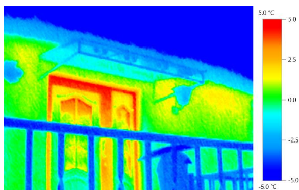
Rysunek 3.125. Ściana zewnętrzna izolowana termicznie. Bardzo niska jakość termiczna ram drzwi zewnętrznych. Widoczny efekt termiczny połączenia ścian zewnętrznych z dachem.
