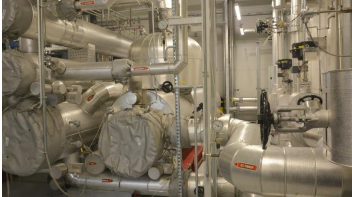
Ilustracja 32: Wizyta w elektrociepłowni
