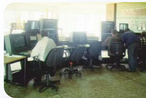
Fot. 19 Sterownia w Zakładach Chemicznych Police
